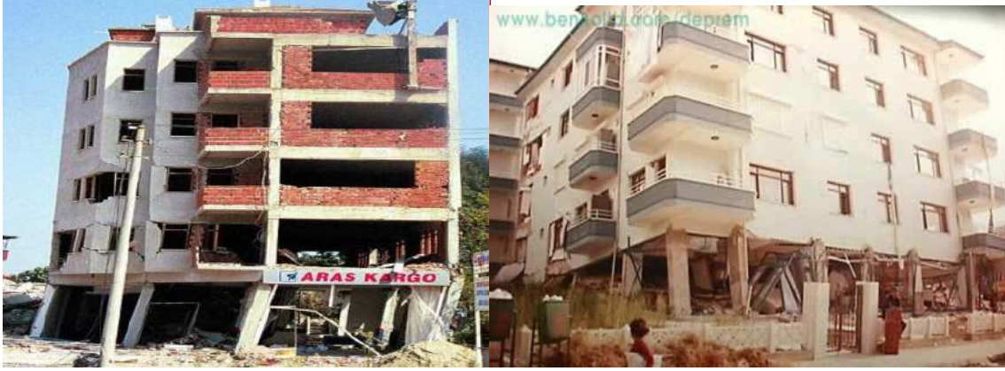
Şekil 7. Yumuşak Kat Hasarları (Türkiye, 1999, M:7.4)
