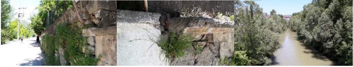
Şekil 6. Bartın Nehir ekosisteminin nemli havasının etkisi altında kalan tarihi lise duvarı.
