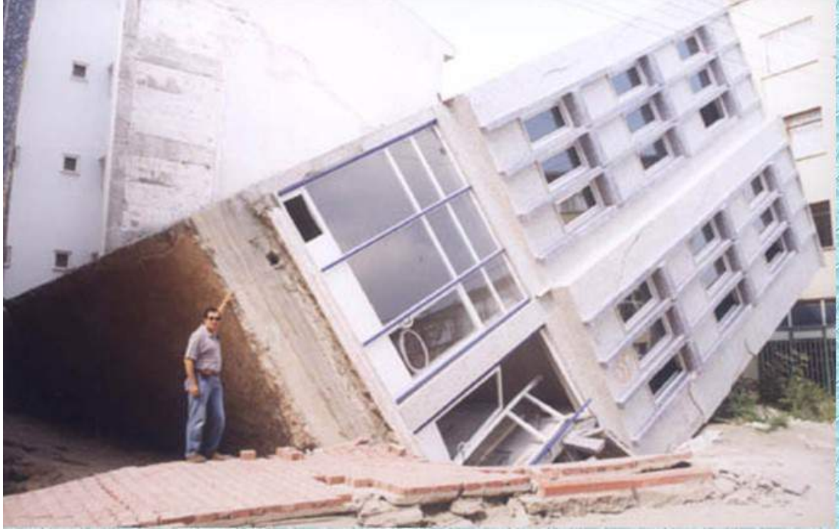
Şekil 1. Zemin Sıvılaşması Sonucu Oluşan Hasar; (Türkiye, 1999, M:7.4)
