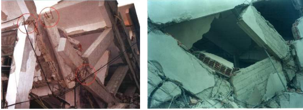
Şekil 10. Çeşitli Depremlerde Gözlenen Düğüm Noktası Hasarları
